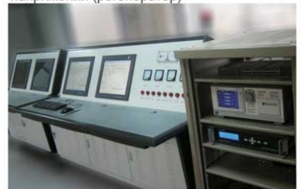
• Центральный пульт управления
