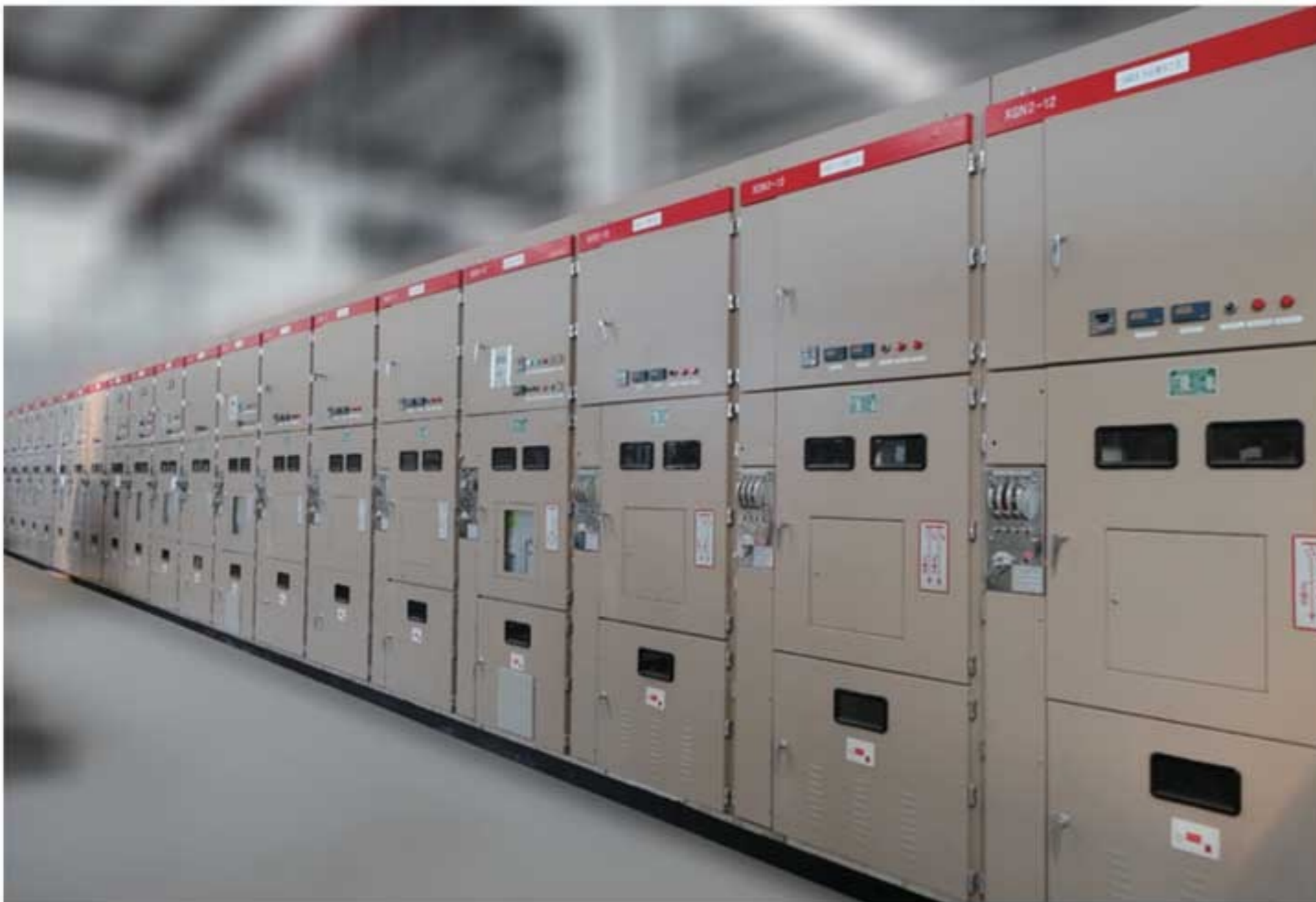
• Распределительные ячейки высокого напряжения
